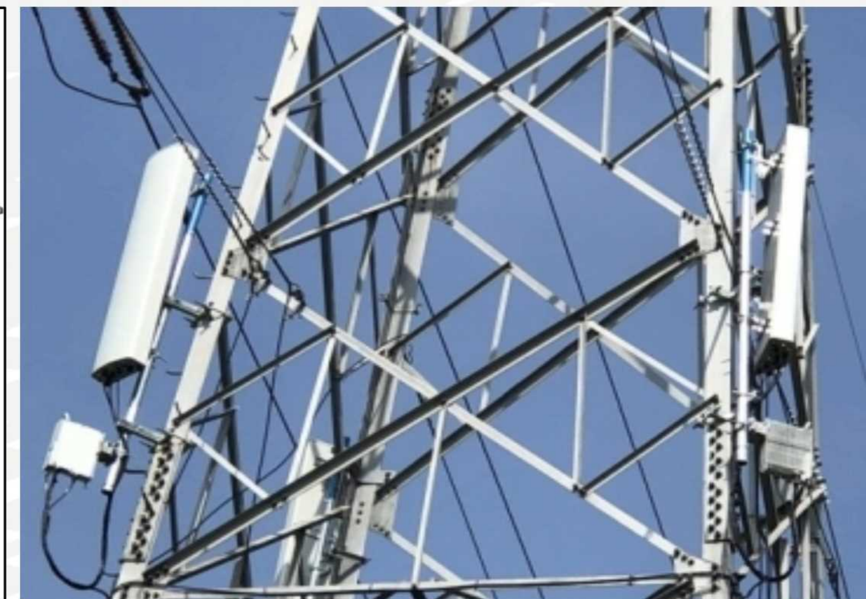
智慧路灯和共享铁塔
