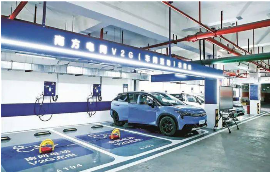
图 10 南方电网在深圳市龙华区民兴苑小区实施车网互动功能验证
