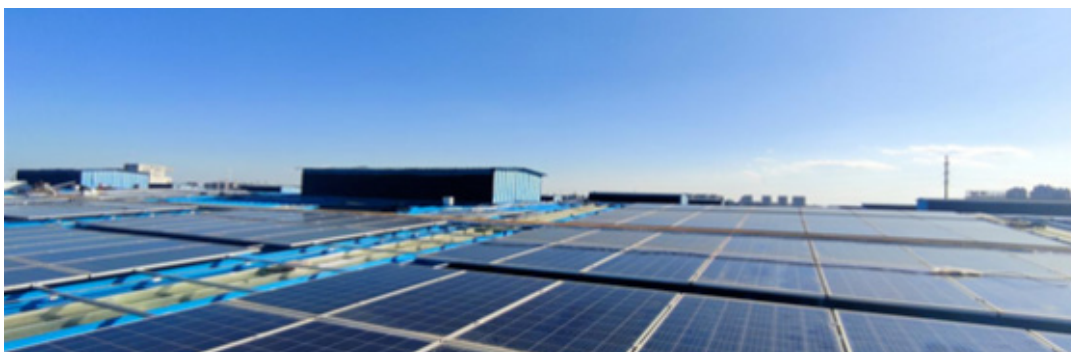
图 2 国家电投奥扬科技低碳示范产业园屋顶分布式光伏项目
