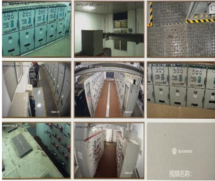
配电房 5G 高清视频监控
