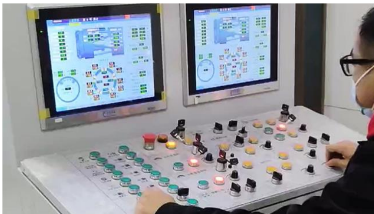
TBM 5G 远程控制
